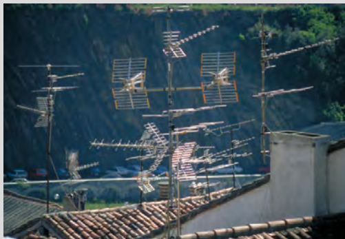
Maraña de antenas de televisión sobre los tejados (Ondarroa). Efecto rebajado en la actualidad con las antenas colectivas y los nuevos sistemas de comunicación.
