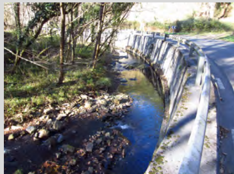
Río Amalloa en el valle de Larruskain con la carretera ocupando parte del cauce del río.
