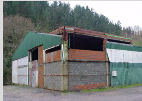
Empresa abandonada de aguas de Urberuaga.
