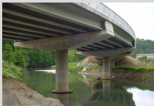
Detalle de la foto de la izquierda: puente con elementos prefabricados, adintelados, en Rentería.
