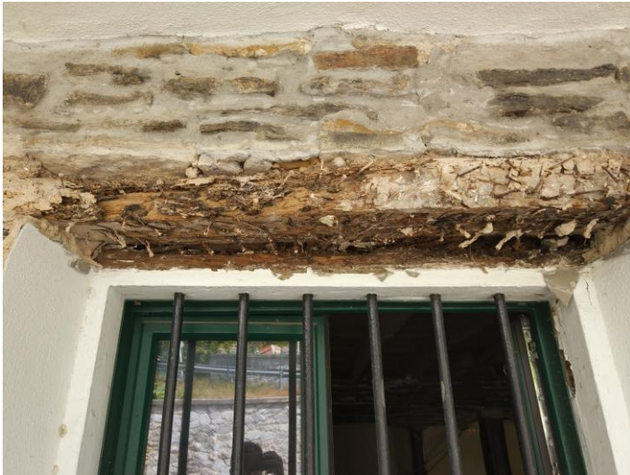
Cargadero de planta baja.
