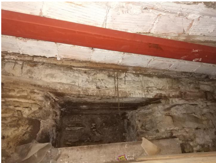
Túneles terrosos de termitas en cargaderos de planta semisótano.
