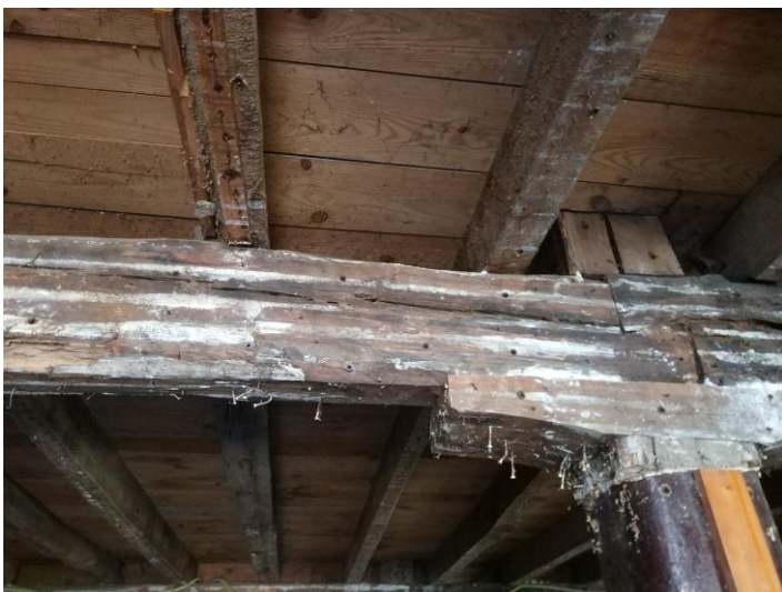
Fendas longitudinales en vigas coincidentes con área de tracción perpendicular a la fibra.
