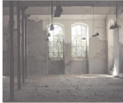
Fig. 6. Estado conservación dei interior.
