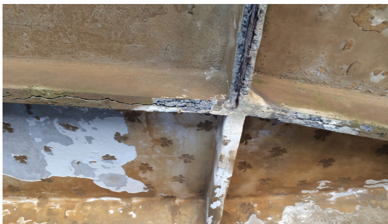
Ilustración 24: Imagen del estado del hormigón, blog reharq.
