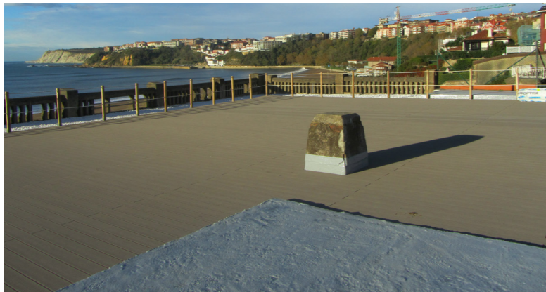
Ilustración 30: Imagen tras la impermeabilización del salón con la salida de la chimenea, imagen propia.
