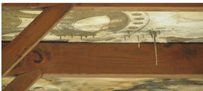
Ilustración 28: Imagen de las estalactitas formadas en el edificio, imagen propia.
