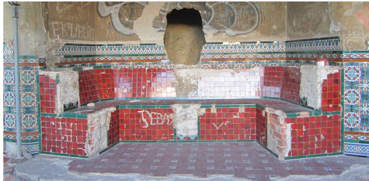
Ilustración 20: Imagen del estado actual del banco de estilo modernista, imagen propia.
