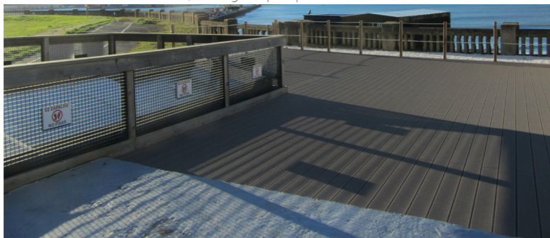
Ilustración 31: Imagen tras la impermeabilización del salón con la terraza proyectada sobre el mismo, imagen propia.
