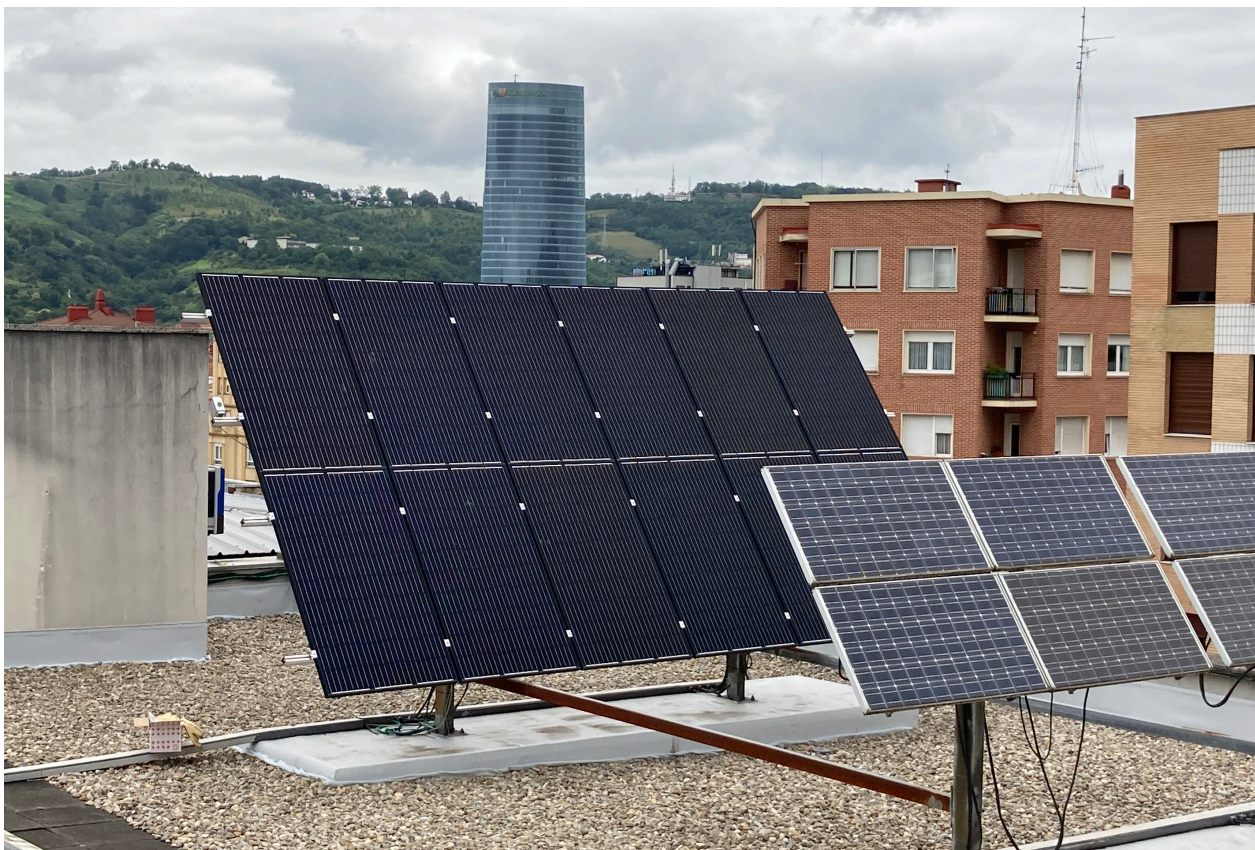
FIGURA 5.7. PANELES FV DE LA ESCUELA DE INGENIERÍA DE BILBAO.
