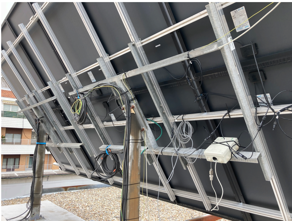
FIGURA 5.9. CABLEADO DE UN MC.
