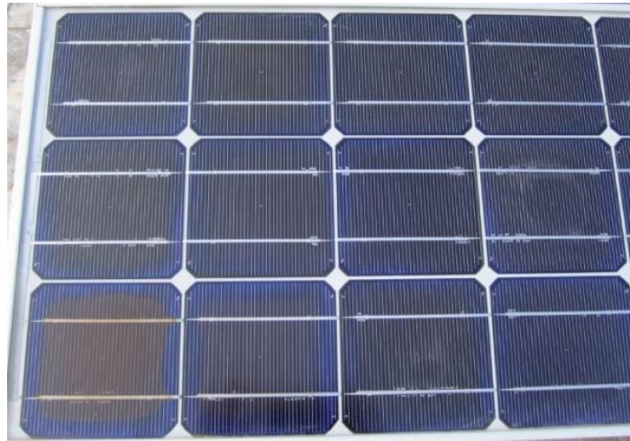
Figura 13. Módulo fotovoltaico con decoloración. [15]
