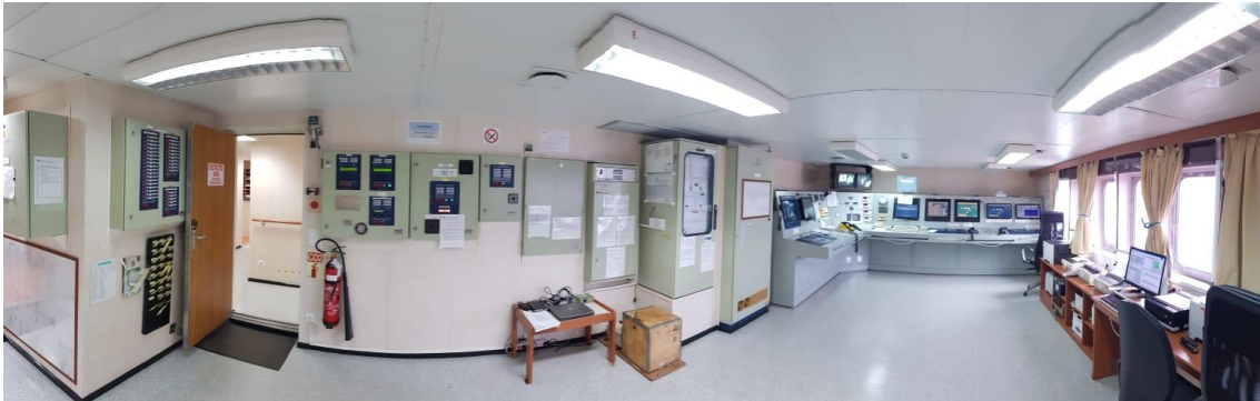
Imagen25. Disposición de algunos equipos del control de carga del buque gasero Bilbao Knutsen
