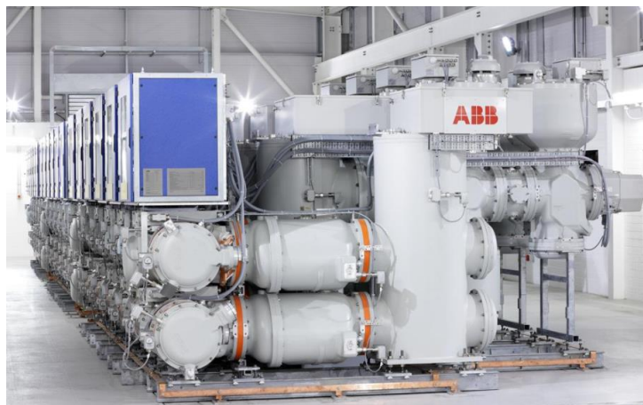
Figura 3: Subestación GIS 110 kV ABB en Irlanda [6]
