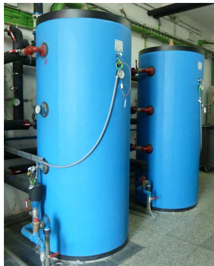
Fig. 6.6 Módulo de Almacenamiento Térmico
