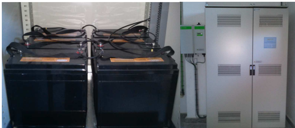
Fig. 6.9 Módulo de Almacenamiento Eléctrico
