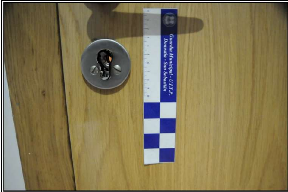
Fotografía nº 9: Mostrando vista de la cerradura forzada de la puerta principal de acceso al domicilio por dentro.
