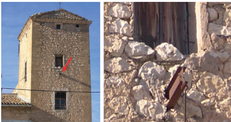
Fig. 55. Imagen de la fachada sureste de la torre con la viga y detalle de la misma.
