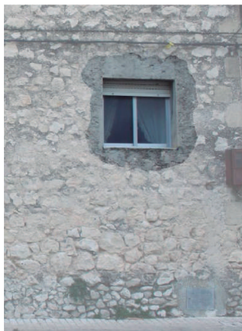
Fig. 67. Vano abierto en el extremo derecho de la primera planta de la fachada noreste.
