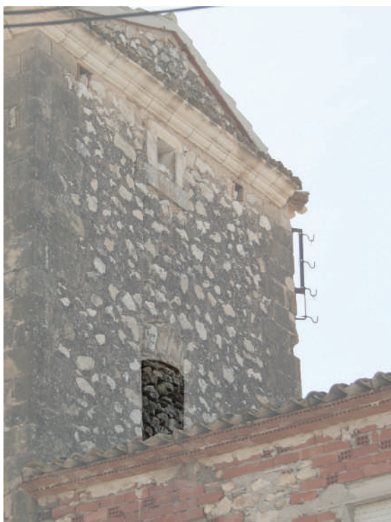
Fig. 42. Ventana cegada del cuarto nivel de la torre en la cara noroeste.
