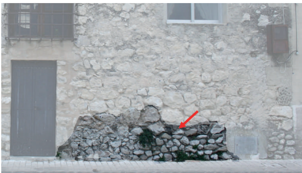
Fig. 54. Detalle de las tareas de reparación para el recalce de la cimentación en la fachada.
