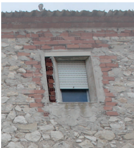
Fig. 69. Reducción del vano del extremo derecho de la nueva planta en el ala noreste del palacio.
