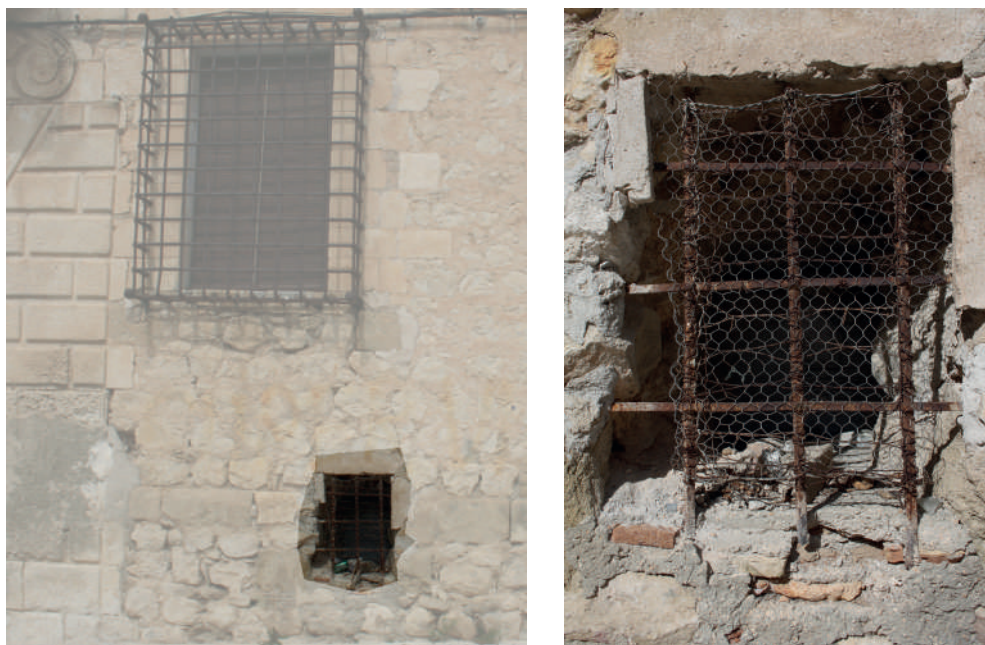
Fig. 35. Vano de iluminación en la parte inferior de la torre y detalle del mismo desde el exterior.
