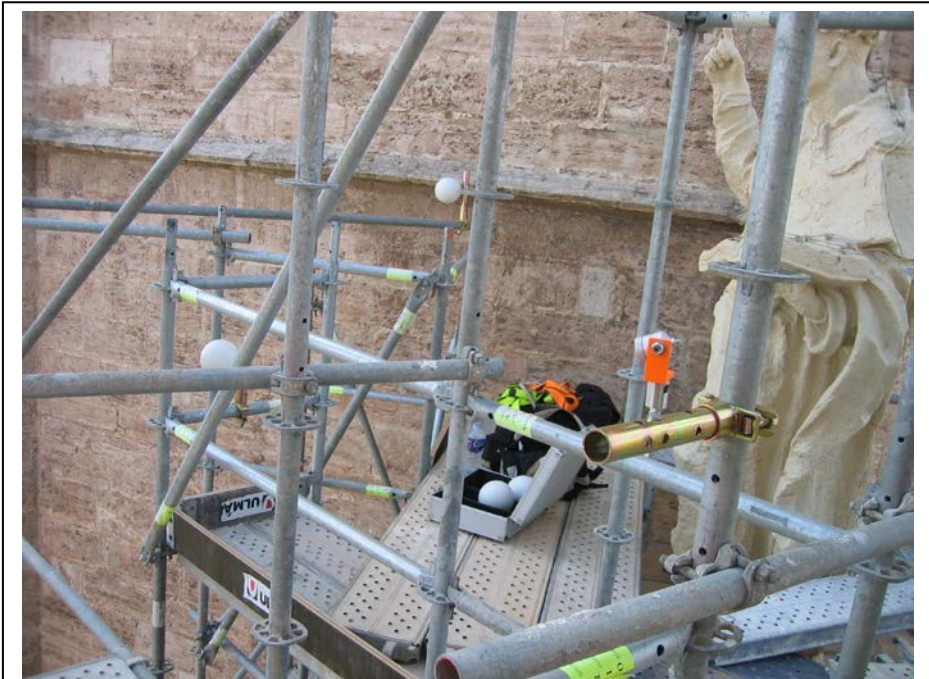
A3.1.- En primer término, se puede apreciar la montura con el miniprisma que define el centro de la esfera en el momento de obtener sus coordenadas mediante topografía. En el fondo se
